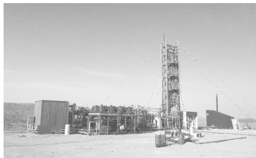
图 10 内蒙古杭锦旗撬装液化装置
